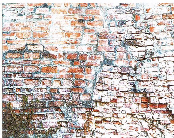
图 9.1.2-3 砌体风化剥落
