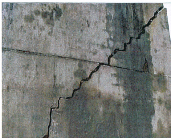
图 9.1.2-1 地基不均匀沉降裂缝
