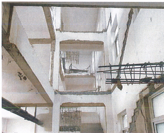
图 5.1.6-1 擅自拆除楼板
