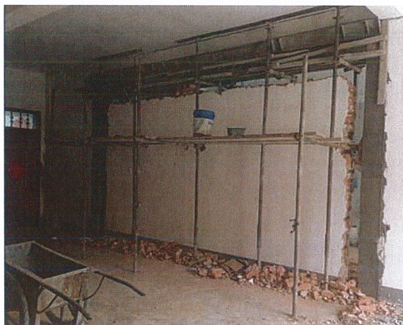
图 5.3.4-1 擅自承重墙体改梁
