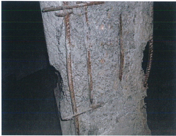
图 9.1.2-5 柱轴心受压损伤
