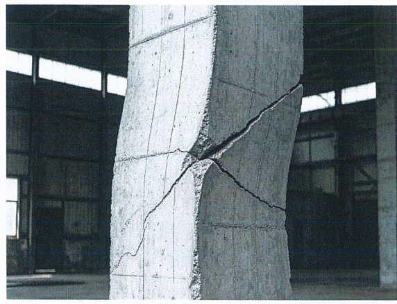
图 9.1.2-6 柱因刚度不足引起的挠曲侧弯变形
