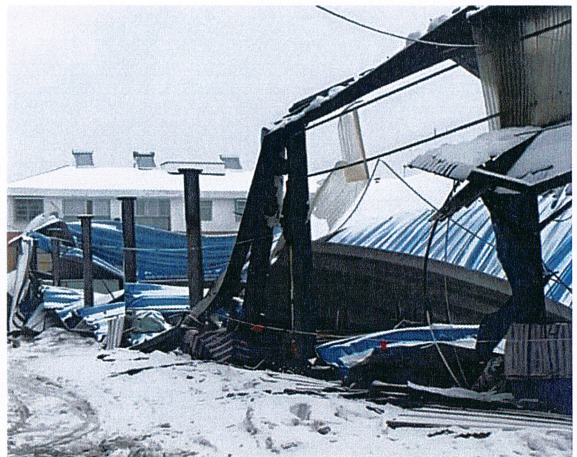
图 5.2.10-2 屋面积雪致仓库垮塌
