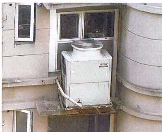
图 5.1.2-1 悬挑板搁置大型空调主机
