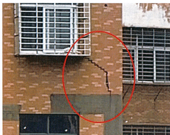
图 9.1.2-2 地基不均匀沉降裂缝
