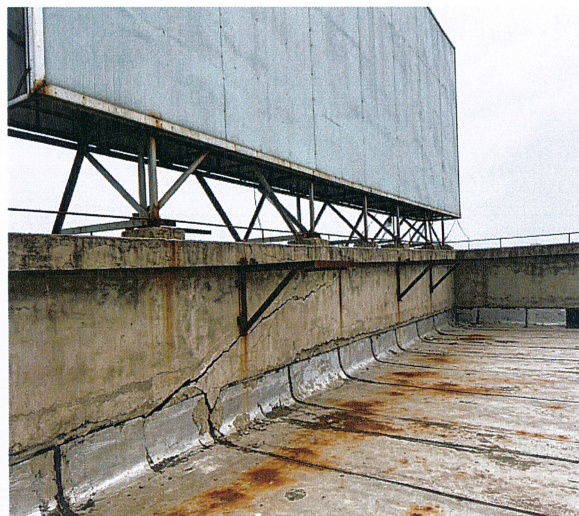
图 5.1.24-2 女儿墙上安装大型广告牌
