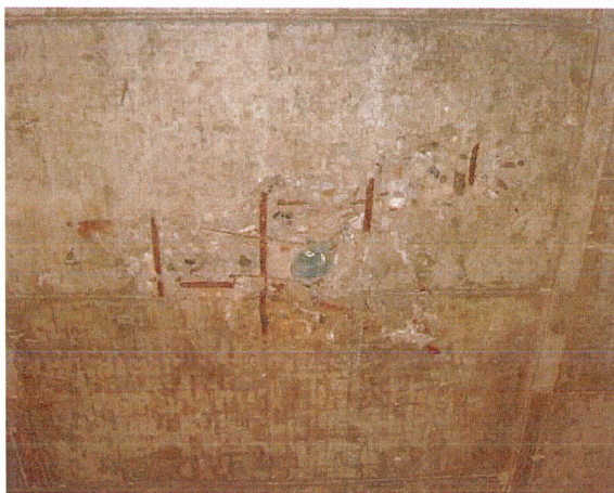
图 9.1.2-7 混凝土酥裂、钢筋外露锈蚀
