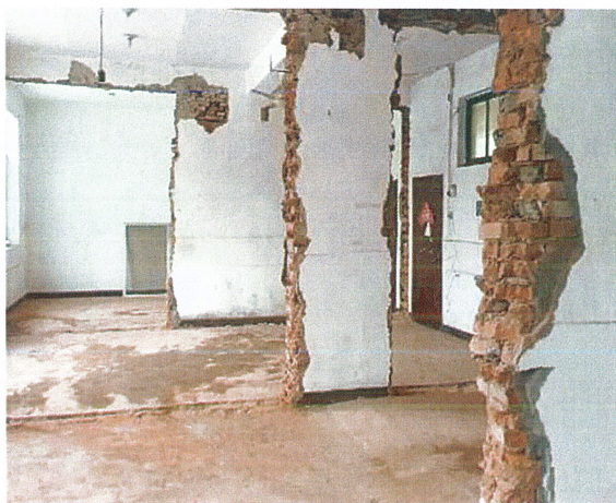
图 5.1.6-2 擅自拆除承重墙
