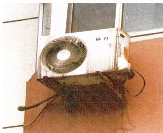
图 5.1.2-2 阳台女儿墙安装空调主机
