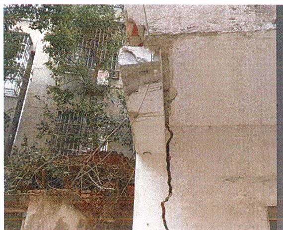
图 5.3.5-1 自建房承重墙体开裂
